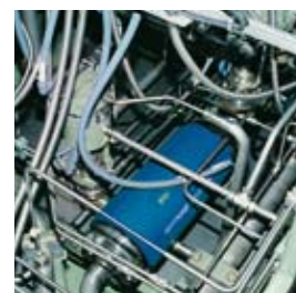
KRAL Volumeter instalado en la sala de motores de un yate.
